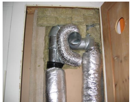
Komfortlüftung im Schrank an der Giesserstrasse 2 (Foto A. Rüegg)
